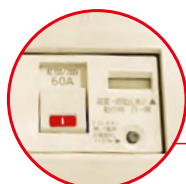
漏電遮断器 (主幹ブレーカー)
