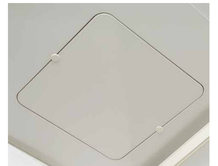
浴室の点検口(例)
