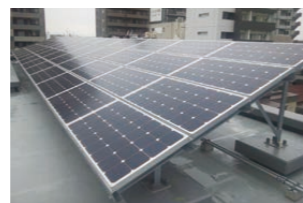
太陽光発電パネル(参考写真)
