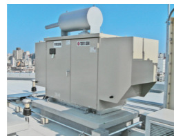
非常用発電機(参考写真)
